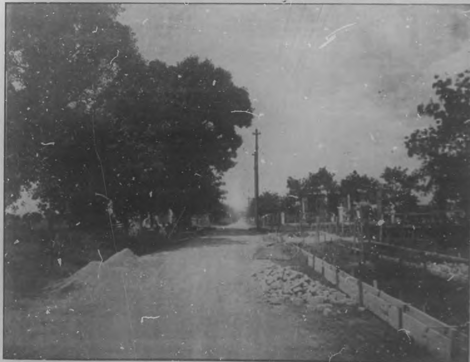
Hermosa vista de una calle con las aceras en construcción. Puede verse en ella el lindo arbolado que constituye una de las mejores atracciones del barrio.
